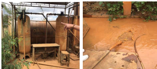
Hình 3. Nguồn nước tại công trình cấp nước sinh hoạt tập trung xã Chư Crăm, huyện CRông Pa, tỉnh Gia Lai, tháng 3/2021
